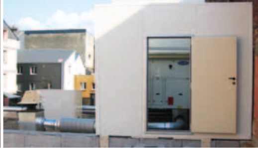
Traitement acoustique d'ensemble de production
