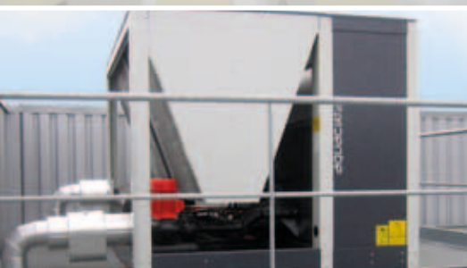
Pompe à chaleur (installation, remplacement, isolation)
