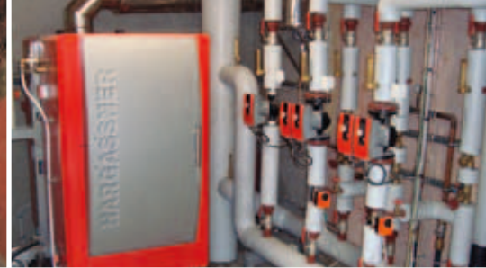
Chaudière bois (granulés, plaquettes, buches)
