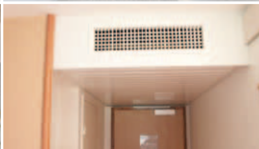
Remplacement ou intégration de ventilo-convecteurs
