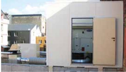
Traitement acoustique d'ensemble de production
