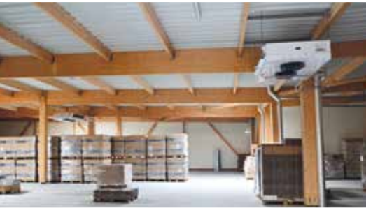
Climatisation de chai de stockage
