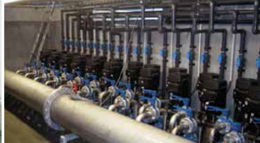
Refroidissement de lignes d'extrusion de plastique
