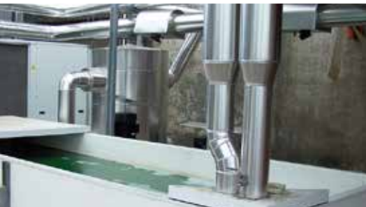
Bac de décantation d'une ligne de refroidissement
