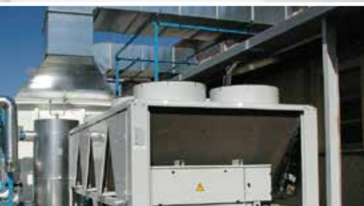
Groupe et caisson de traitement d'air
