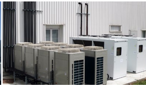
Groupes de condensation extérieurs
