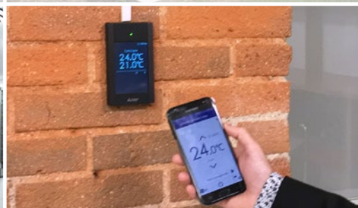
GTC : contrôle permanent et optimisation de l'installation
