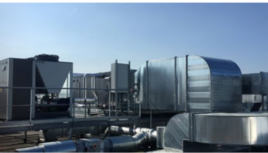
Groupes d'eau glacée en terrasse
