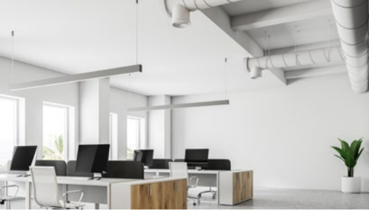
Chauffage et rafraîchissement de bureaux
