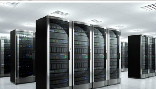
Climatisation des salles serveurs
