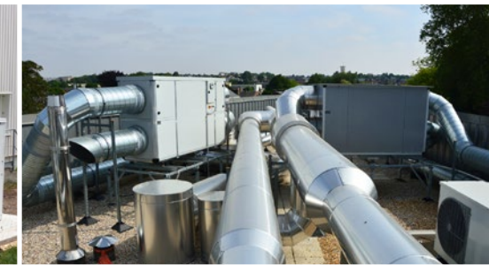
Traitement d'air : ventilation permanente, optimisation par zoning, qualité d'air (CTA double flux)
