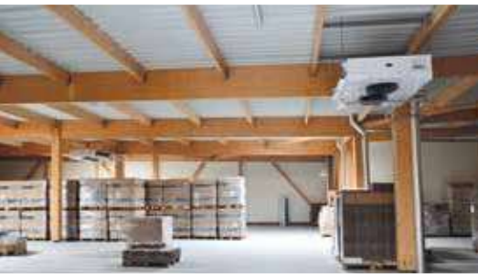
Climatisation de chai de stockage
