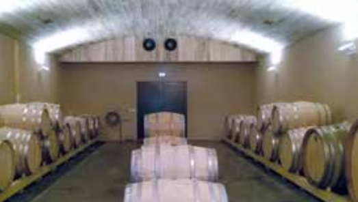
Climatisation haute hygrométrie de chai à barriques
